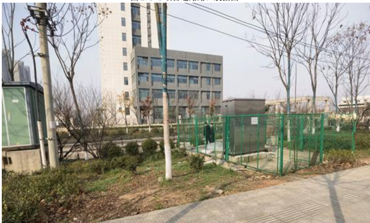
图 2.1-5 一体化泵站现状图
